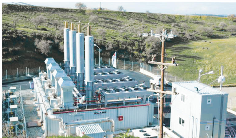
Σταθμός ηλεκτροπαραγωγής από βιοαέριο στους Ταγαράδες από τον ΗΛΕΚΤΩΡ
