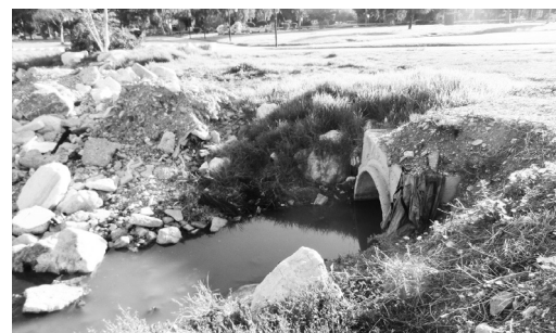
Αγωγός που καταλήγει μπροστά από παρκινγκ Καλεντζιώτη
